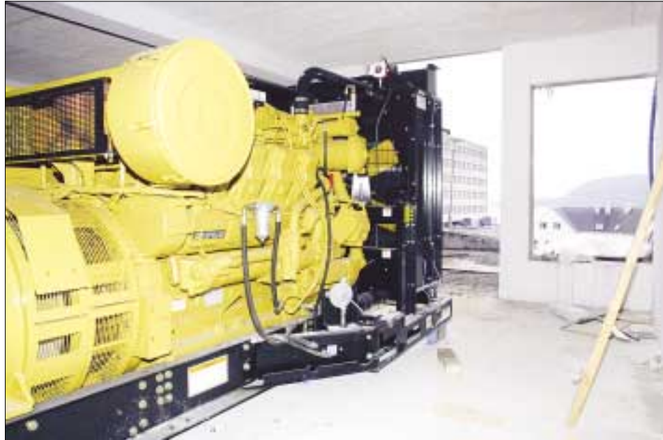
Teir gomlu motorarnir á Landssjúkrahúsinum. Hvør motorur er 180 kVA og við teimum noyðist ein at velja burturúr, hvør skal fáa streym og hvør ikki.
