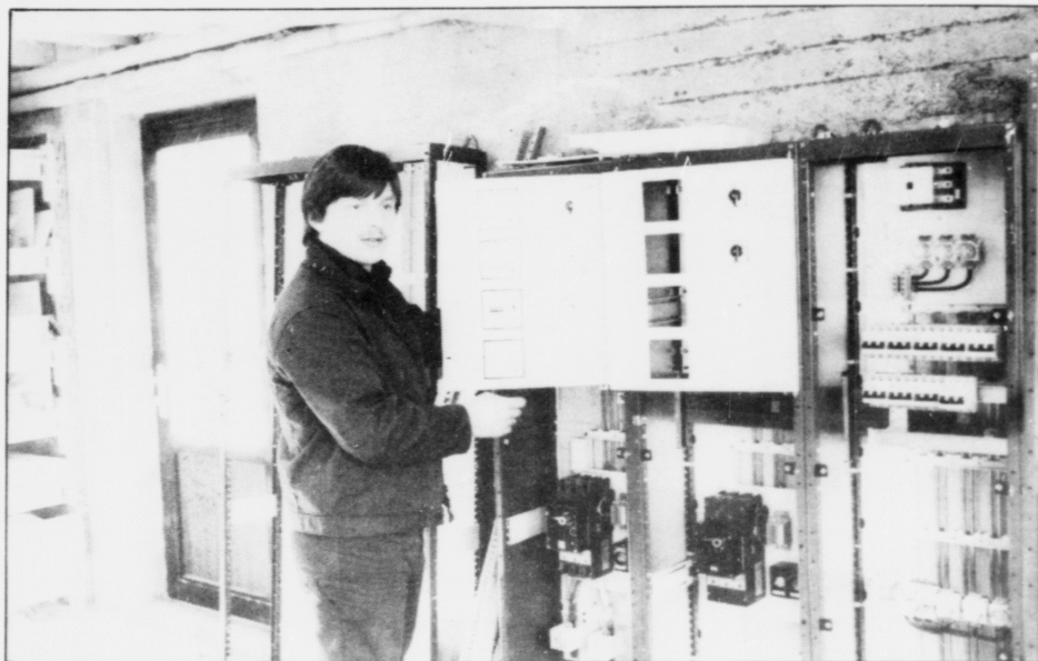
Ein trupulleiki við uppseting av el-talvum hevur verið, at tað hevur verið langt millum framleiðaran í t. d. Danmark og arbeidsplassið í Føroyum, um broytingar skuldu gerast. Við virkinum í Norðragøtu er vunnið á hesum trupulleikanum
