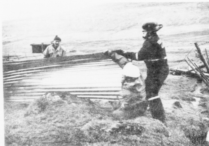
Slökkiliðsmenn í ferð við at forða hesum vandamiklu plátunum at fara í luftina úti í Havnardali
