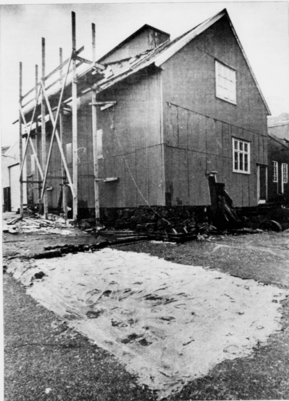
Stórur partur av asbesttekjuni er skiftur út, men bert nakrar fáar plátur eru at finna niðri í túninum. IRF hevur ikki fingið nakra asbestplátu av hesi tekju. Okkum hevur ikki borið til at fingið uppspurt hvar restin av asbesttekjuni er endað, men herfyri var eitt djúpt hol í túninum við húsinu. Nú er hetta hol fyllt upp og í skundi er stoypt út yvir hetta øki sæst fremst á myndini, sum myndamaður okkara tók norðuri við Áir í gjáramorgunin. Mynd: Kalmar Lindenskov
