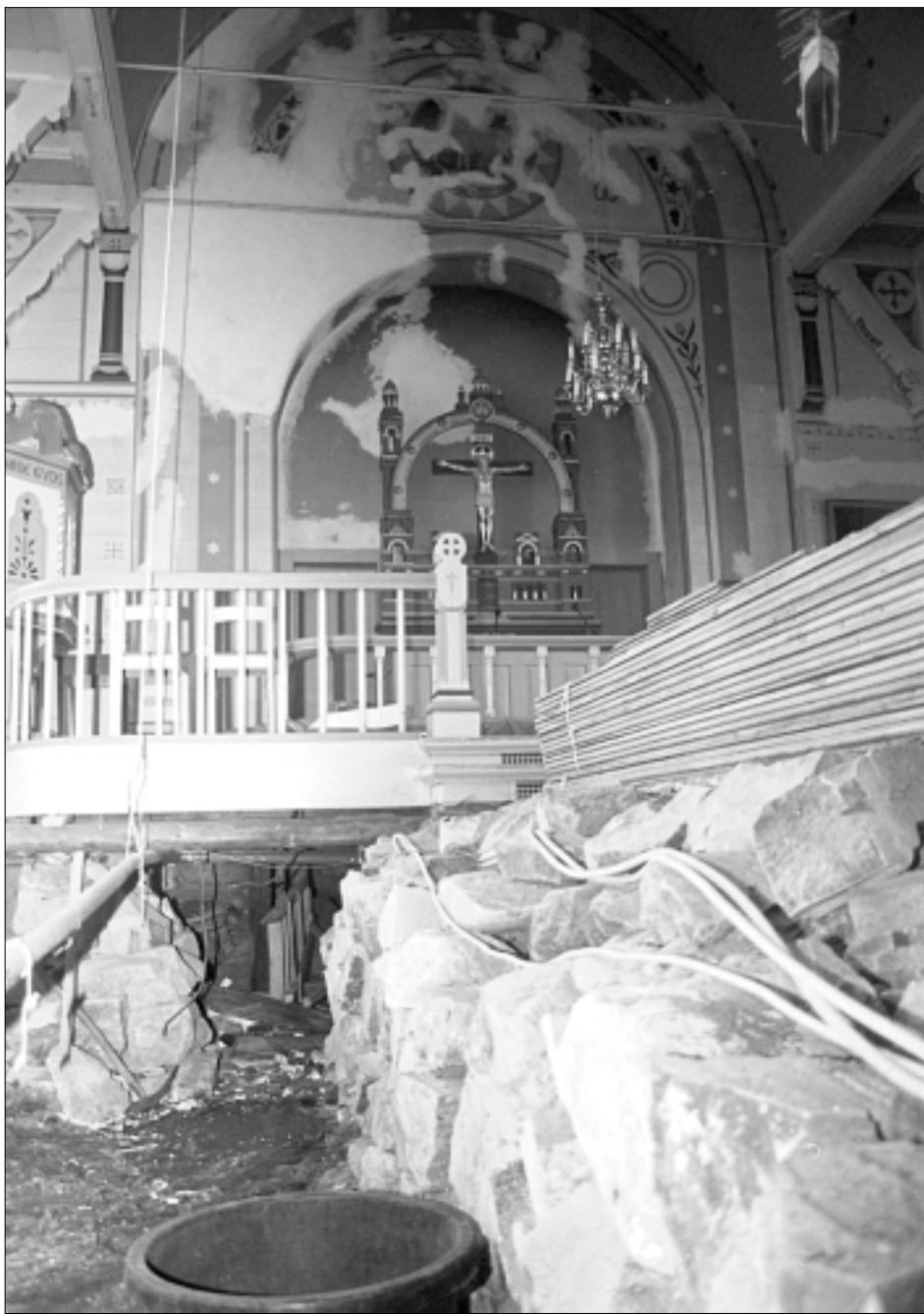
Gólvíð í Eiðis kirkju er tikið upp og skal skiftast út
