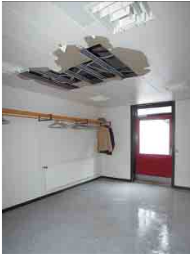
Í fleiri støðum er loftið heilt illa farið av nógvu vætuni, og einstaka staðni er tað dottið niður
