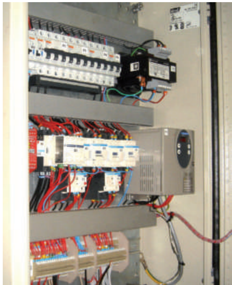
Teir eru serkønir í at projektera el-anlegg, framleiða el-talvur, projektera og installera sjálvvirkandi skipanir av ymskum slagi
