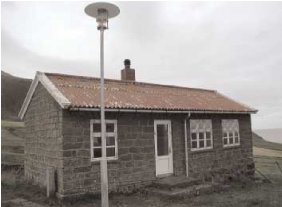
Skúlin á Trøllanesi stendur framvegis tómur. Umvælingarnar av skúlanum eru ikki gjørdar, hóast bygðaráðið hevur pengar tøkir til neyðugu arbeiðini
