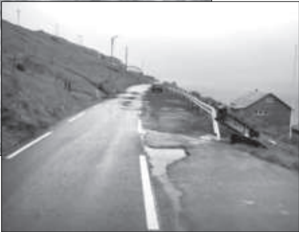
Selatraðarvegurin er breiðkaður í støðum. Hetta arbeiðið er væl gjørt, men nøktar als ikki tørvin fyri ein veg í 2008
