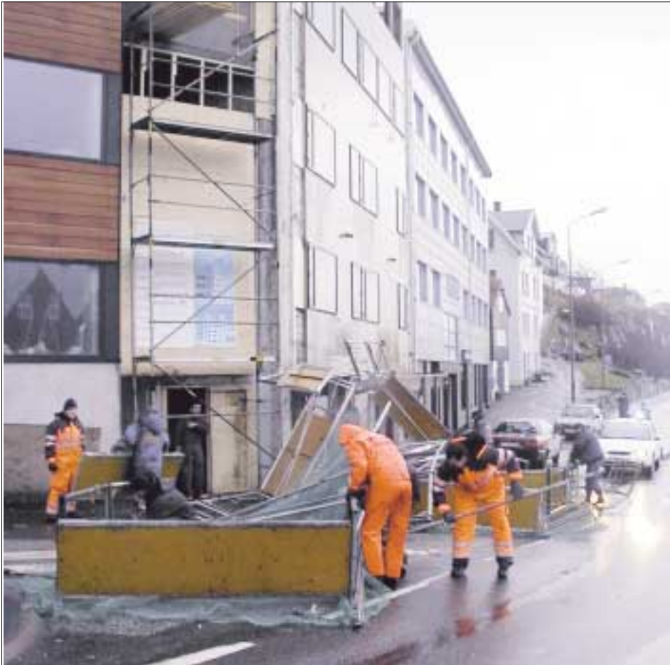
Menn frá byggifelagnum og slökkiliðnum arbeiddu við at beina koppaða stilassið burtur leygardagin. Tað koppaði í vandinum leygardagin, hóast menn høvdu tryggjað og kannað stilassið
